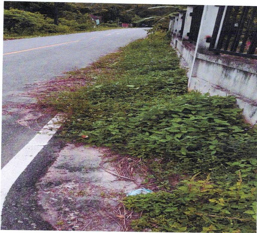
ภาพก่อนดำเนินการโครงการ รางระบายน้ำคอนกรีตเสริมเหล็กถนนสายทุ่งปรีอ หมู่ที่ ๔
